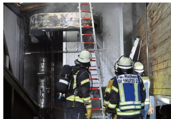
An der Hackschnitzelheizung wurden Elemente entfernt, um den Brandherd bekämpfen zu können.
